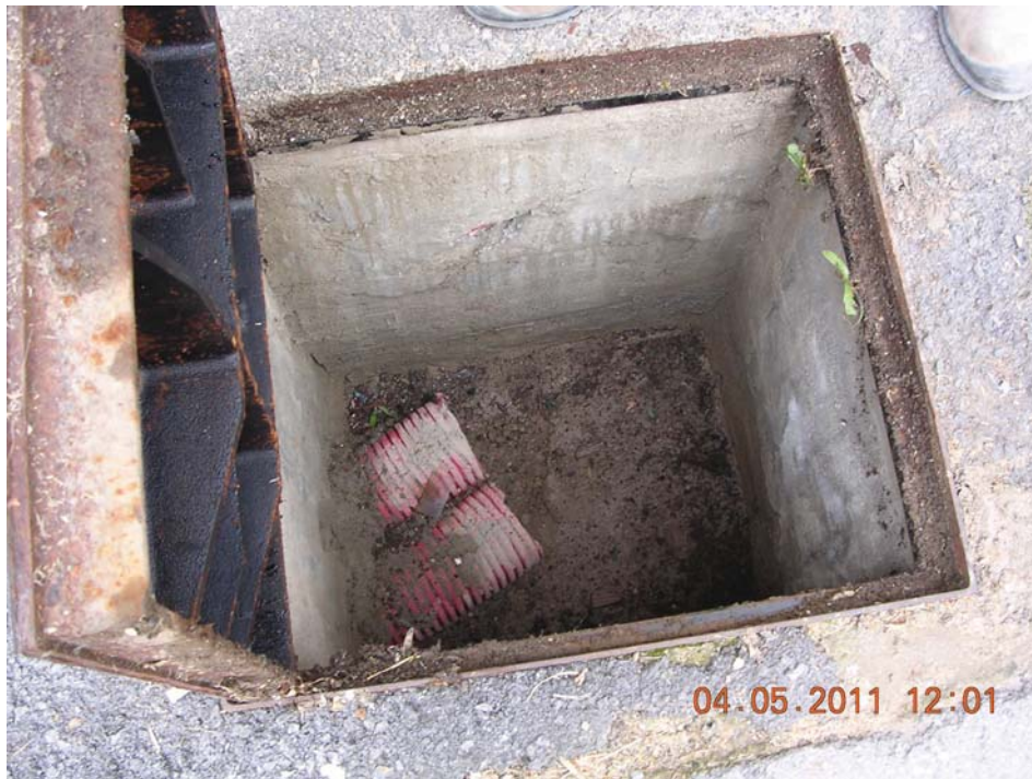
Arqueta de acometida subterránea
