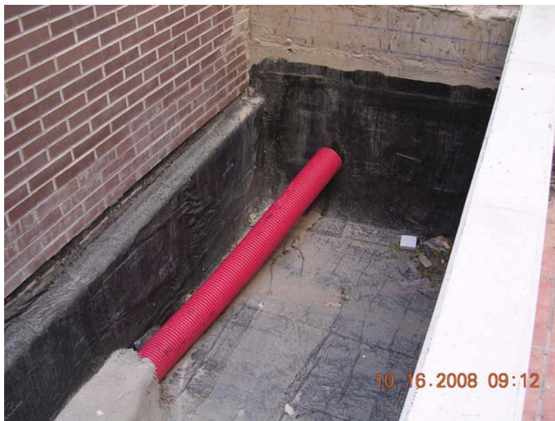
Conducción de línea general de alimentación
