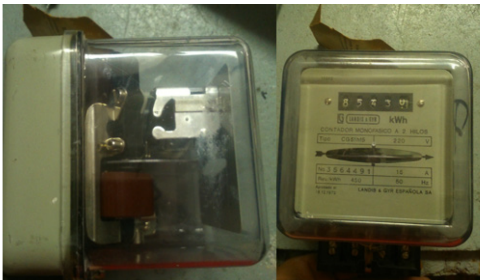
Contador eléctrico analógico, sin carcasa
