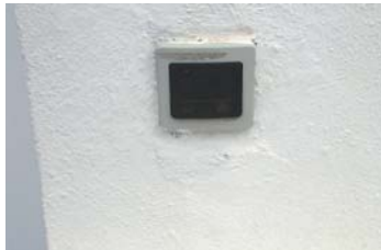
Detalle de una instalación.
