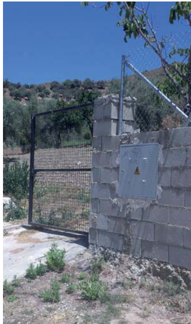
Caja de protección y caja de contador
